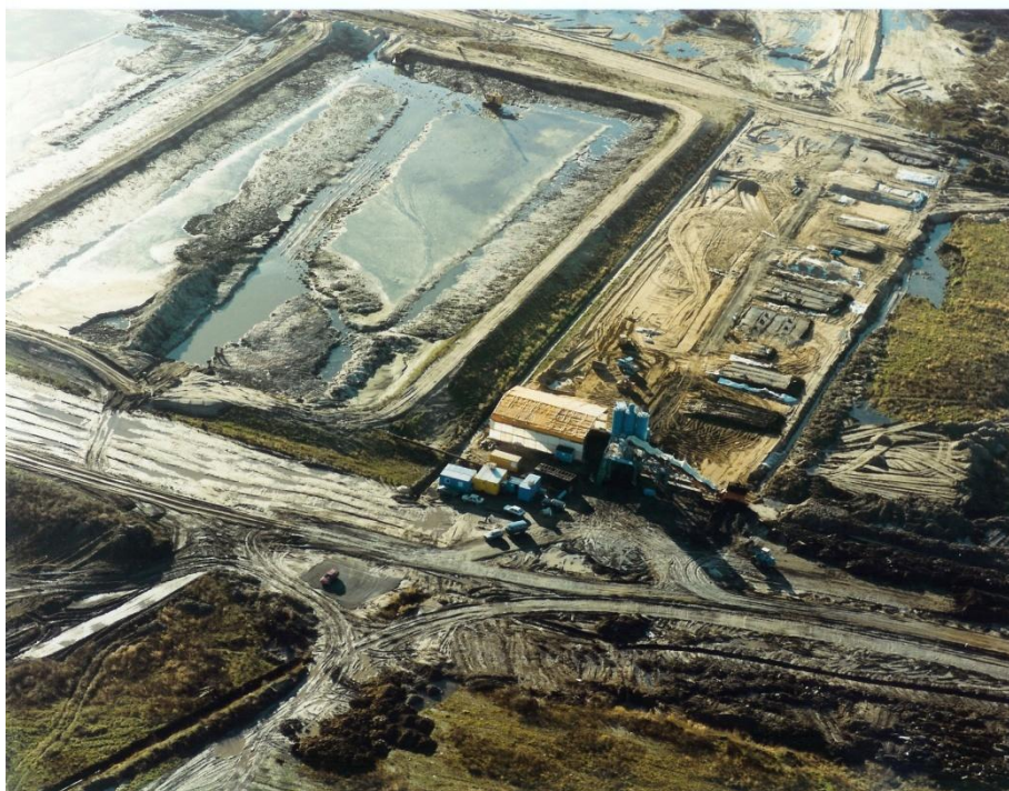
Figura 37 Vasca di colmata
