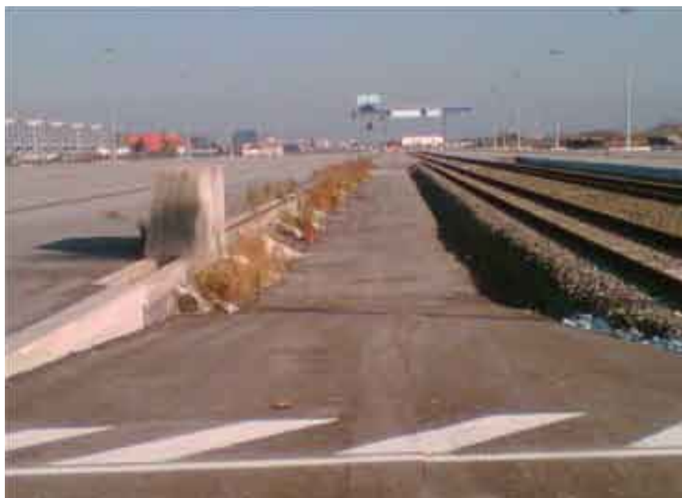
Terminal ferroviario dell'Interporto A. Vespucci
